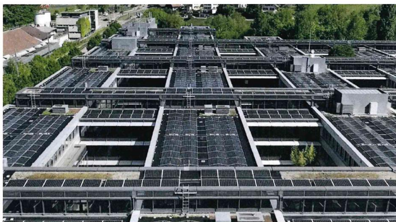
Neu dehnen sich die Photovoltaikanlagen über das gesamte Dach des Hauptsitzes.
